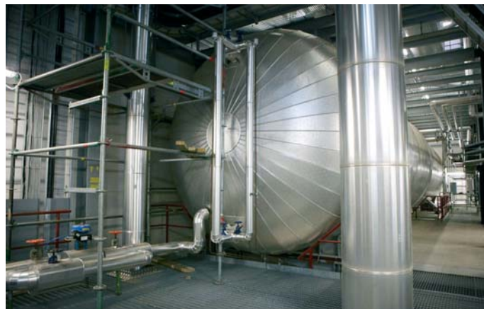
Matarvattentanken på bilden är 22 m lång och 4 m i diameter. Den 70 ton tunga matarvattentanken kördes hit från Finland på en 44 m lång trailer.
