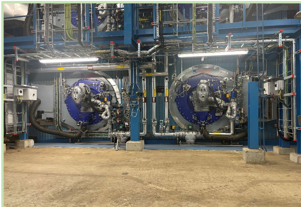
Nytt brännarsystem i spetspannan på Igelsta värmeverk.
